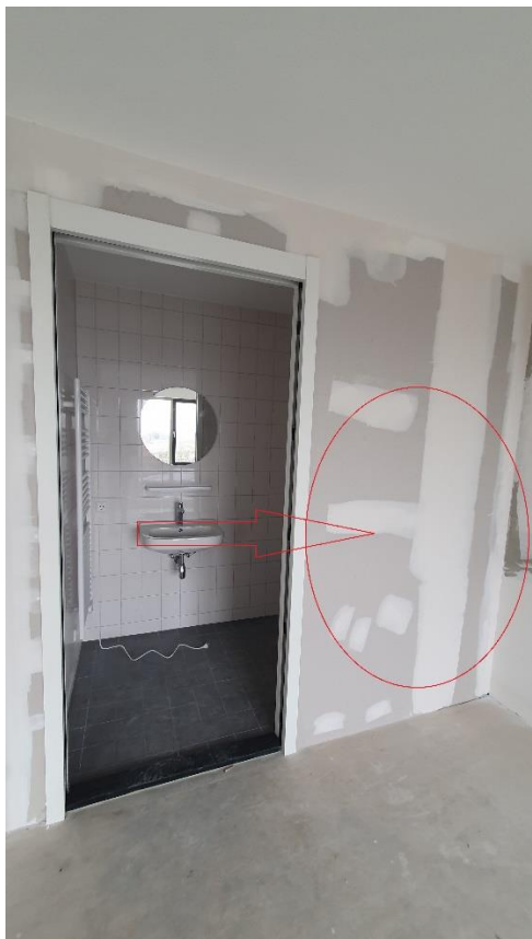
Voorbeeld: wand slaapkamer/badruimte
