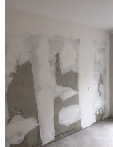
Foto betonwand met luchtbellen 2
